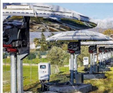
Energia pulita Un impianto fotovoltaico di ultima generazione
