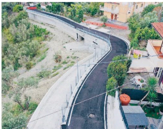
Via Nino Padella Riaperta al traffico dopo 10 anni dal primo smottamento
