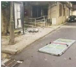
I postamat distrutti a Feroletto della Chiesa
